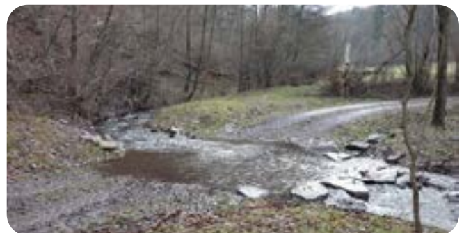
Abb. 6: Keßbach-Daudenberg KD-1 bis KD-4; (o.) KD-1: Vor der Renaturierung – Wegedamm mit Mehrfachverrohrungen. Mittelwassersituation, bei Niedrigwasser können Wasserorganismen die Rohre nicht mehr bachaufwärts durchwandern; (2. v. o.) KD-2: Einbau von massiven Trittsteinen für Wanderer; (3. v. o.) KD-3: Vorne Grundschwelle unterhalb Furt, eine weitere in Höhe der Baumgruppe links; (u.) KD-4: Furt fertiggestellt – abgesenkter Wegekörper, unter Wasser beidseits mit Wasserbausteinen am Furtrand begrenzt, Trittsteine unterhalb der Furt, tief in das Gewässerbett eingegraben
