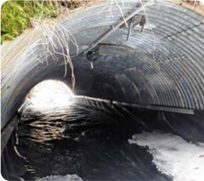
Abb. 1: Abflussmessung an der Fließgewässermessstation mittels Radar- und Ultraschallsensoren an der Messstrecke innerhalb eines Amcro-Thyssen-Profiles als Bachdurchlass an der unteren Banfe (Foto: Bernd Schock)
