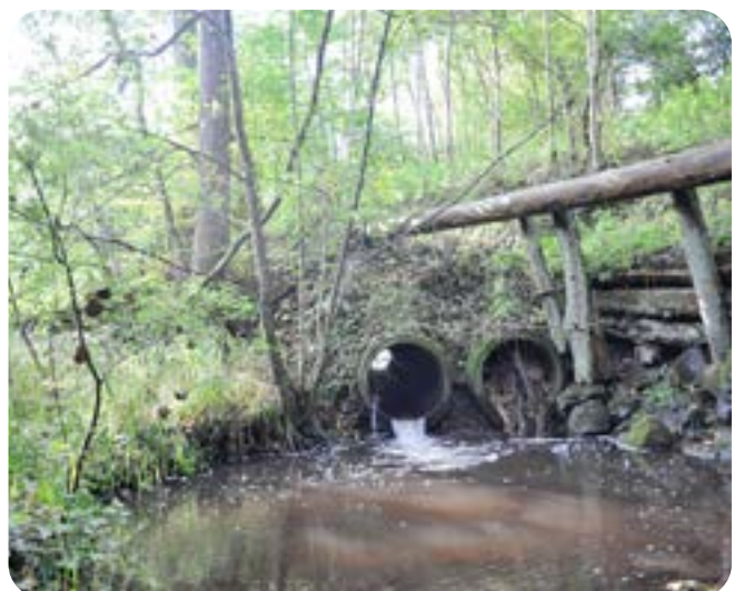
Abb. 13 WRRL 3: Doppelverrohrung mit Abstürzen und großer Auskolkung – keine Durchgängigkeit bachaufwärts für Bachorganismen
