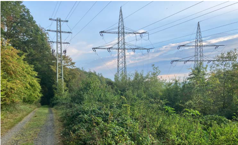
Foto C 5.7: Stromtrasse bei Buhlen / Waldeck
